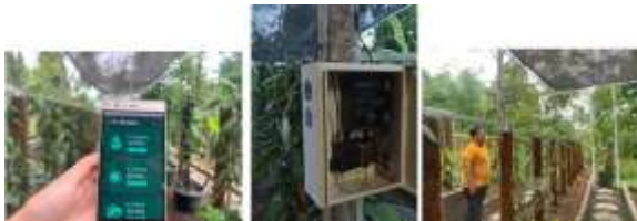
Gambar 6. Instalasi Teknologi V-Growz
